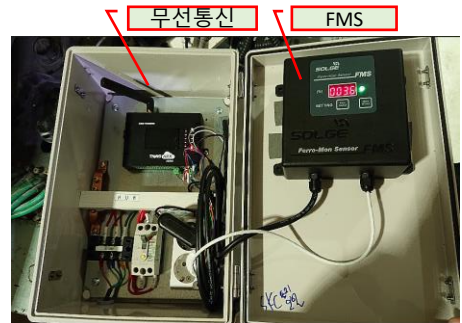
[압출기 감속기 윤활유 탱크/무선통신]
